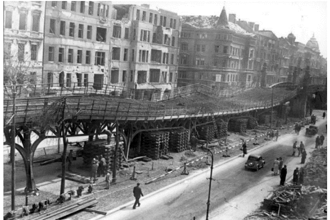
25.7.1944: Bombenschaden an der Hochbahnstrecke in Berlin-Schöneberg. Der Viadukt an der Bülowstraße erhielt am 19. Juli 1944 bei der Explosion einer Luftmine schwere Verwerfungen. Durch Holzstapel und Balken wird die Strecke provisorisch abgestützt.
